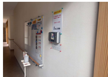
通用口機械警備
