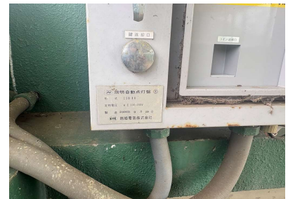
照明電源（岩崎電気 CSB11）
