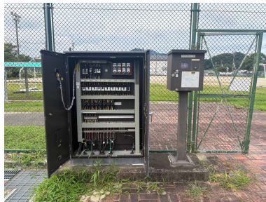
照明操作盤（左）※鍵は無い
