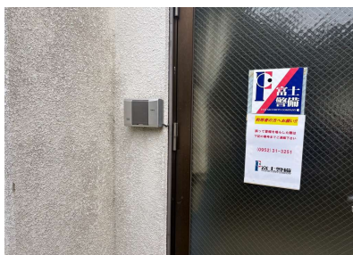
機械警備は玄関（屋外）に設置
