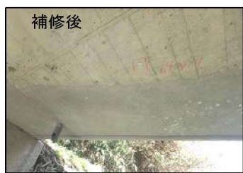
RC床版橋の鉄筋露出
