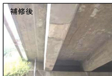
RCT桁のうき
