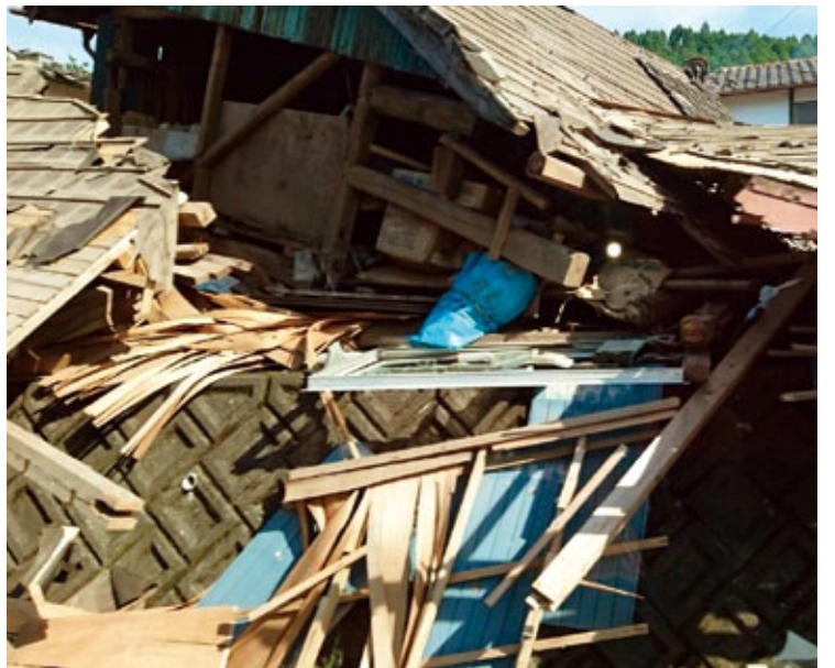
▲熊本地震で全壊した住宅
