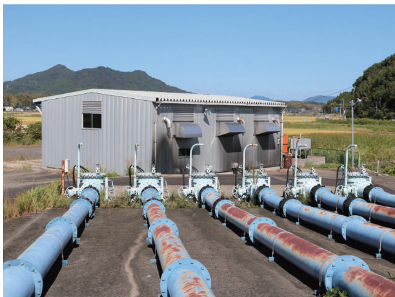
▲浸水、冠水対策として排水機場増設が望まれる
