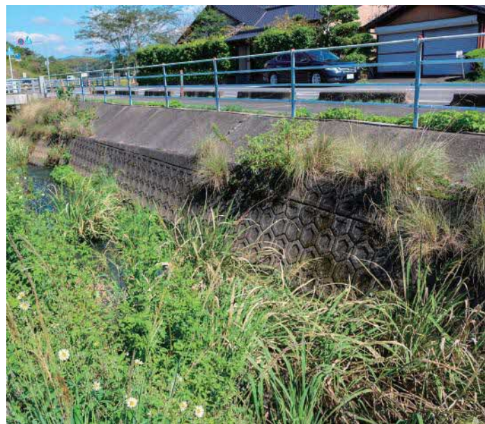
▲浚渫が急がれる東川
