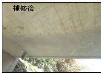
RC床版橋の鉄筋露出
