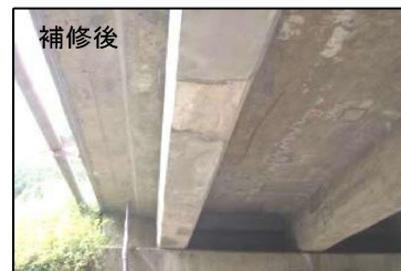
RCT桁のうき
