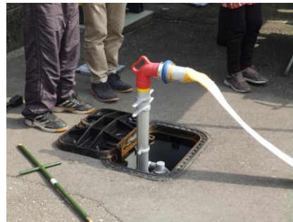
地下消火栓からのホース接
