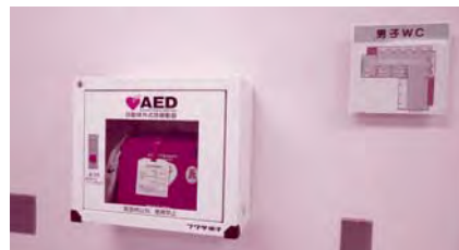
今回、嬉野市公会堂に設置した AED
