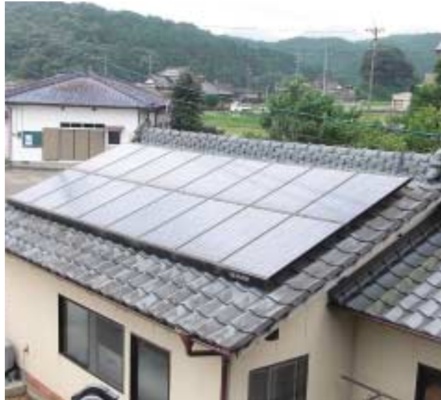
設置が進んでいる太陽光発電
