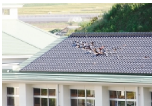
▲吉田中屋根瓦被害
