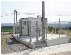
▲陣野ポンプ場（上岩屋）
