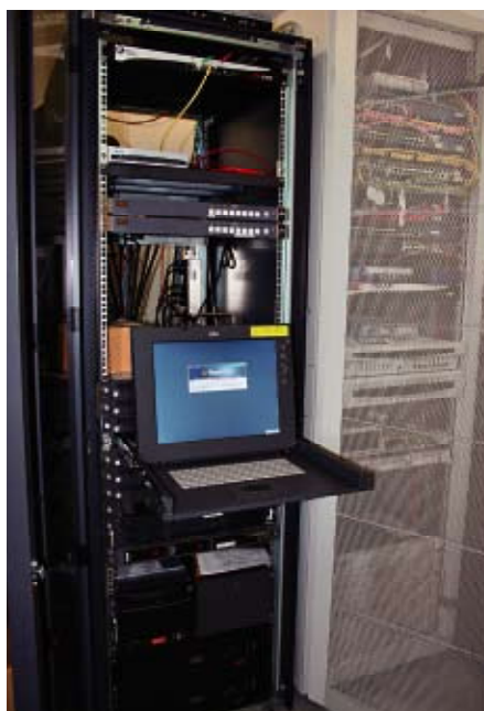
▲ 市役所内のサーバー
