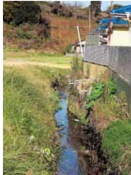
崩壊が心配される水路
