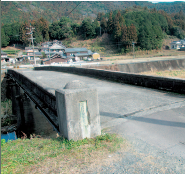
▲老朽化した橋
