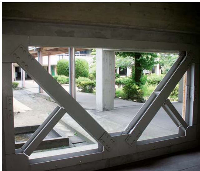
▲巨額な費用がかかる耐震補強
