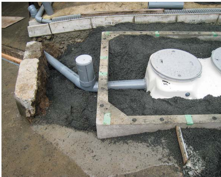
▲家庭に引き込まれた浄化槽設備
