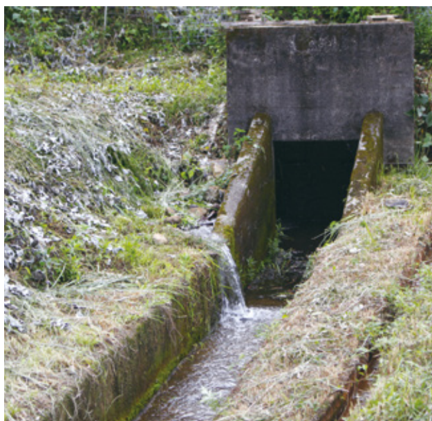
▲ため池の漏水、改修費用をどうするのか
