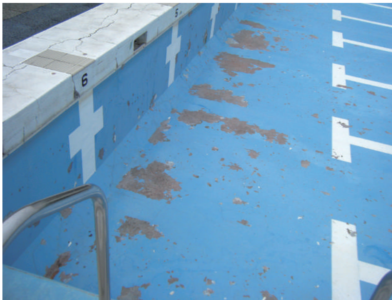
老朽化が進んだプール
